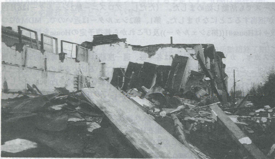
崩壊する建物
